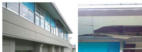
写真-2 体育館の被害状況
