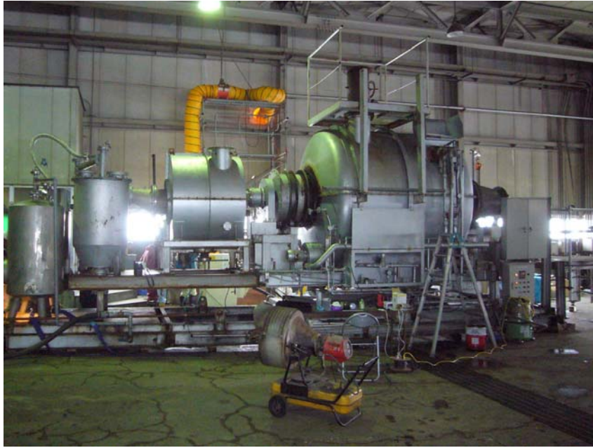
写真-1 ダイオキシン類無害化装置
