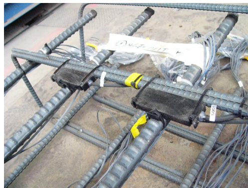
コンクリート配筋に設置した RFID タグ (RFID タグを介して外部と通信)
