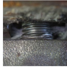
写真 2 ボルト引抜け状況
