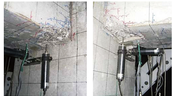
(a) 北側梁端部 (b) 南側梁端部 写真-4 梁端部破壊状況 ( R=1/33\text{rad.}2 回目)
