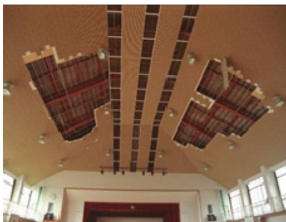
写真-1 天井落下被害の一例
