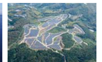
長崎田手原メガソーラー発電所
