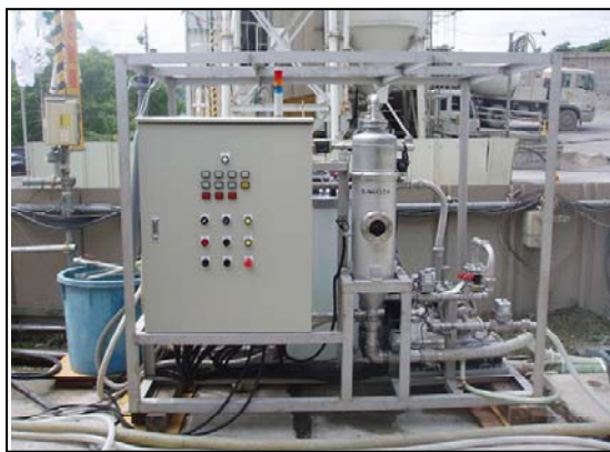
写真-1 TS フィルターろ過装置 処理能力 (1~1.5m 3 /h)
