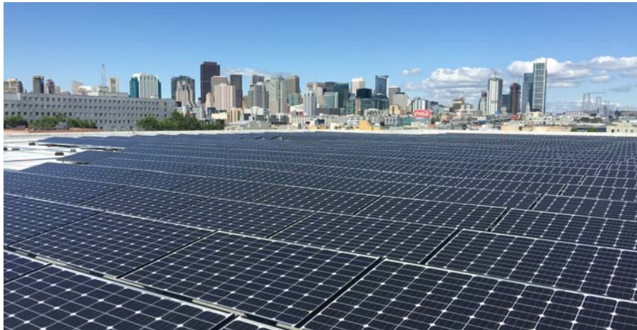
写真1 戸田ビルディングサンフランシスコ屋上 太陽光パネル敷設状況
