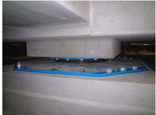
写真 2 T0-HIS 工法 (弾性すべり支承)
