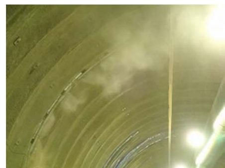
写真3 トンネル内のミスト噴霧状況
