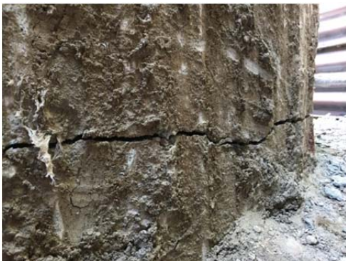
写真1 凍結圧力による水平ひび割れ発生状況
