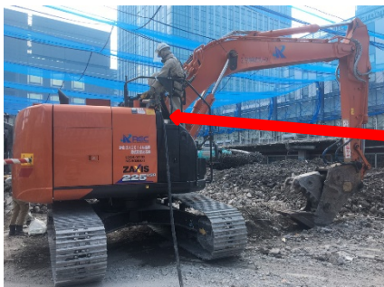
GTL給油状況
