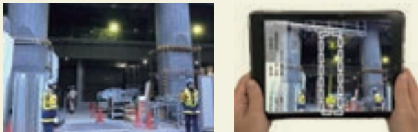
3Dモデル(高所作業車)設置前後のイメージ(左:設置前、右:設置後)
