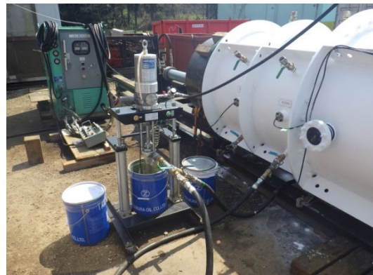
写真2 グリースポンプ
