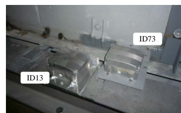
写真-2 地震計設置状況
