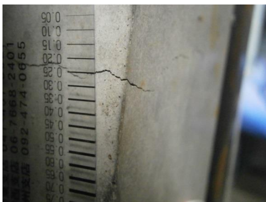
写真 - 5 ひび割れ幅 (4 週経過後, プレーン : 0.25mm)
