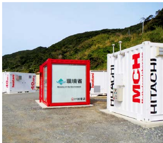
水素製造プラント
