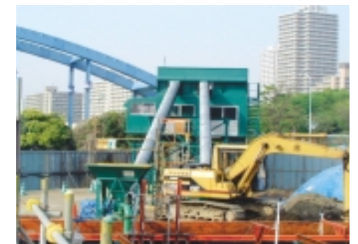
不溶化処理プラント
