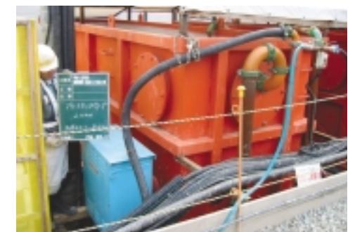
場内廃水処理槽
