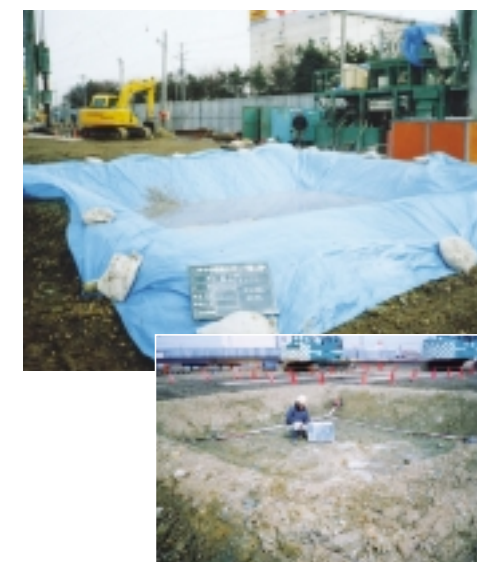
汚泥の天日乾燥ピット
