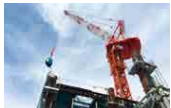
タワークレーンの3次元自動誘導システム
