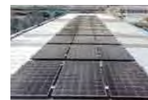
屋根上の太陽光パネル
