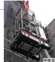
機械室ユニット
