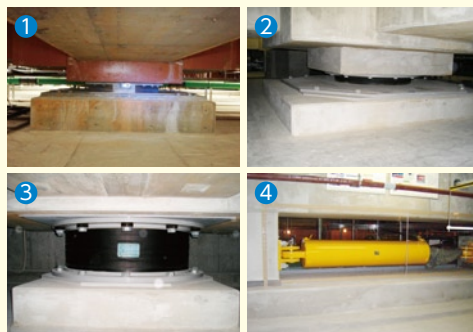
①剛すべり支承 ②弾性すべり支承 ③天然ゴム系積層ゴム ④オイルダンパーの免震装置を建物の基礎部に合計240基、最適に配置しています。
