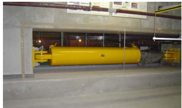
写真5 オイルダンパー
