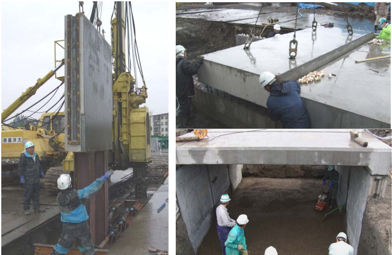
写真-1 施工性能確認試験状況（左：H鋼付側壁部材建込み、右上：頂版部材の架設、右下：内部掘削）
