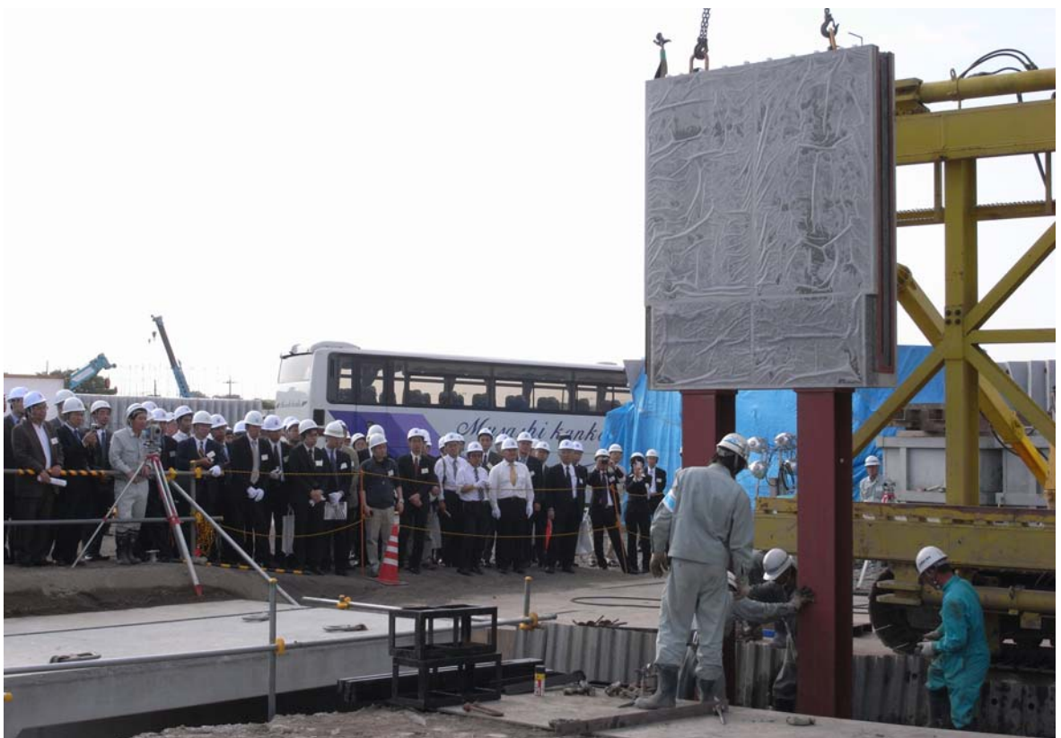
写真-2 施工性能確認公開試験状況 ( 上 : 頂版部材の架設、中及び下 : H鋼付側壁部材建込み)
